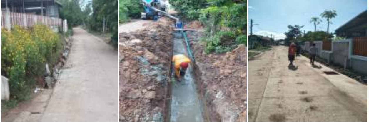
โครงการปรับปรุงถนน คสล.โดยปูผิวแอสฟัลต์ติกคอนกรีต สายกลางบ้าน ห้วยหามต่าง หมู่ที่ 8
