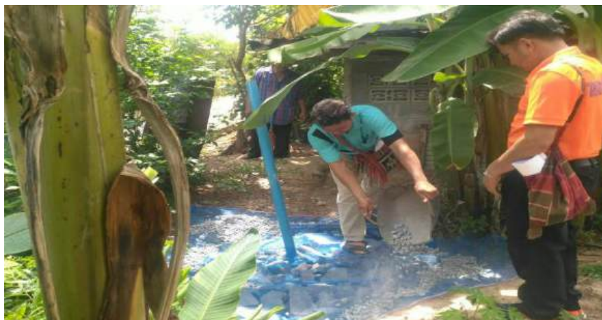
ภาพ บ่อซีเมนต์ระบบธนาคารน้ำใต้ดินหลังบ้านเพื่อลดปัญหาน้ำเน่าเสียและท่วมขัง
